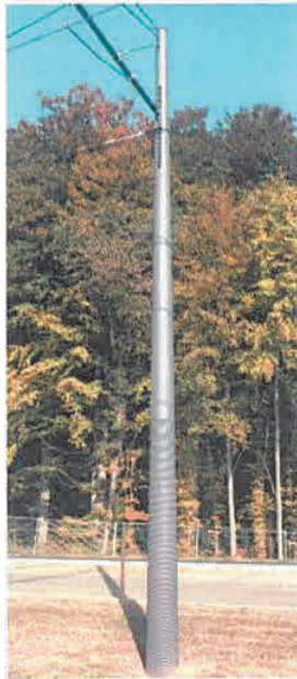
Mât support de la ligne aérienne de contact
