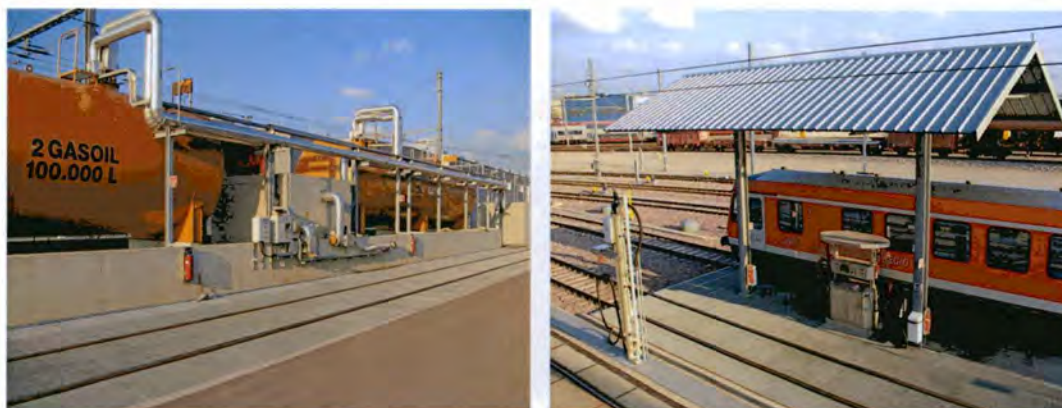
Figure 6: Station de ravitaillement en gasoil
