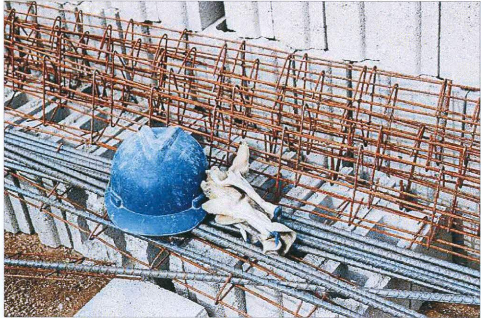
Der Mangel an bezahlbarem Baumaterial führt an vielen Baustellen dazu, dass die Arbeiten unterbrochen werden müssen.
