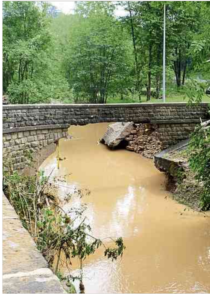
Ernzal, Juli 2016: die zerstörte Brücke in Höhe der „Hessemillen“ als Beispiel für die Folgen von Wetterextremen. (FOTO: ARMAND WAGNER)
